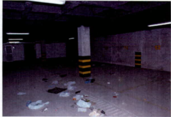
Falta de aseo
