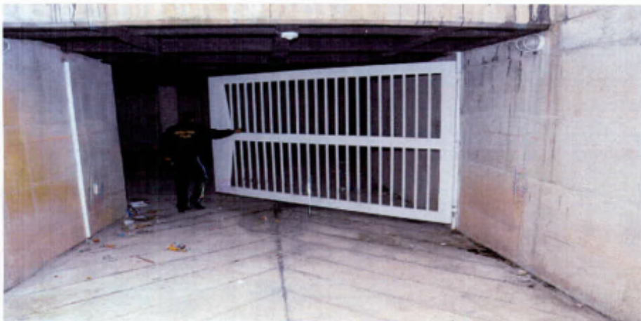
Estado de la zona de acceso vehicular.
