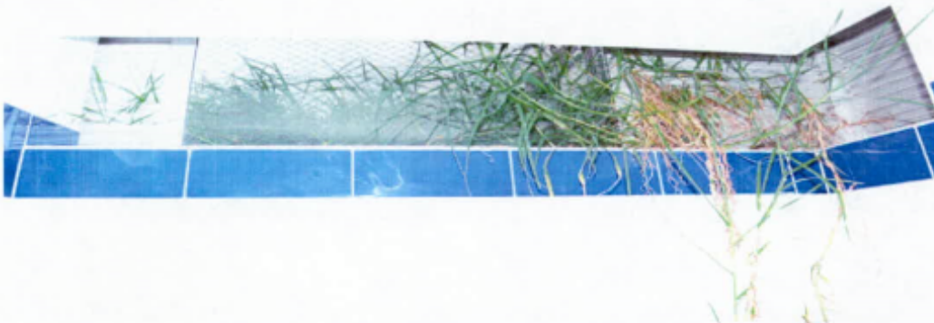
La maleza se adhiere a los muros de la construcción.
