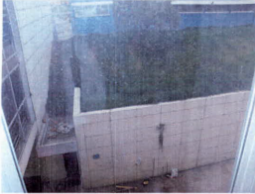
Fisura de muros
